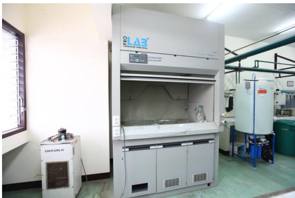
รูปที่ ก.62) ตู้ดูดควัน (Hood, Fume Hood)
